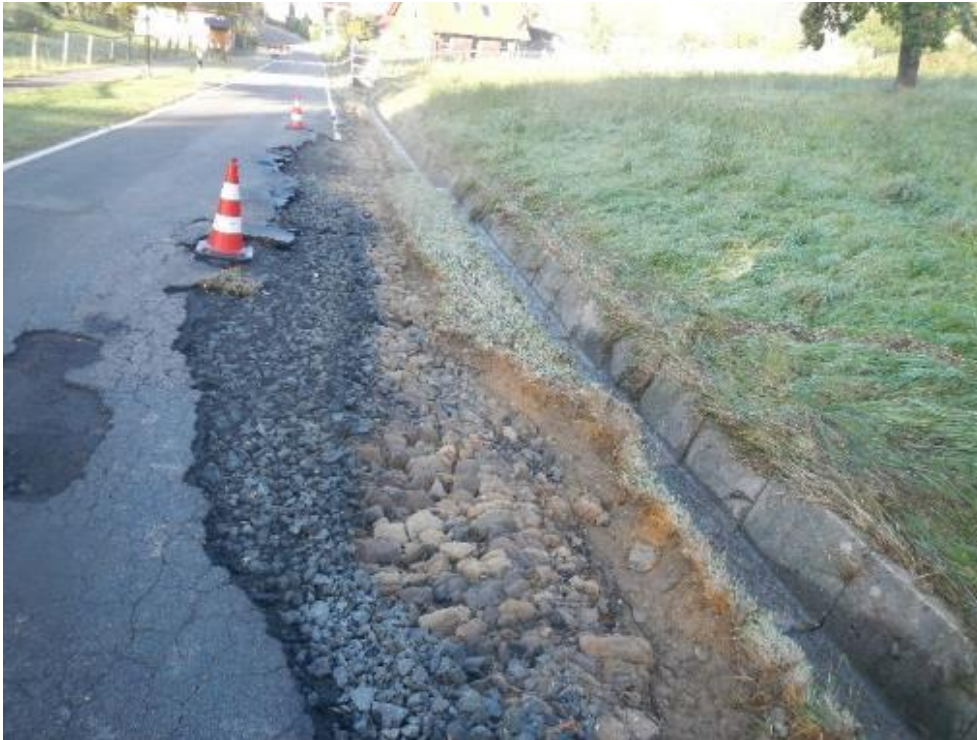
Abbildung 16 Durch Starkregen unterspülte Straße (Beispielbild)
