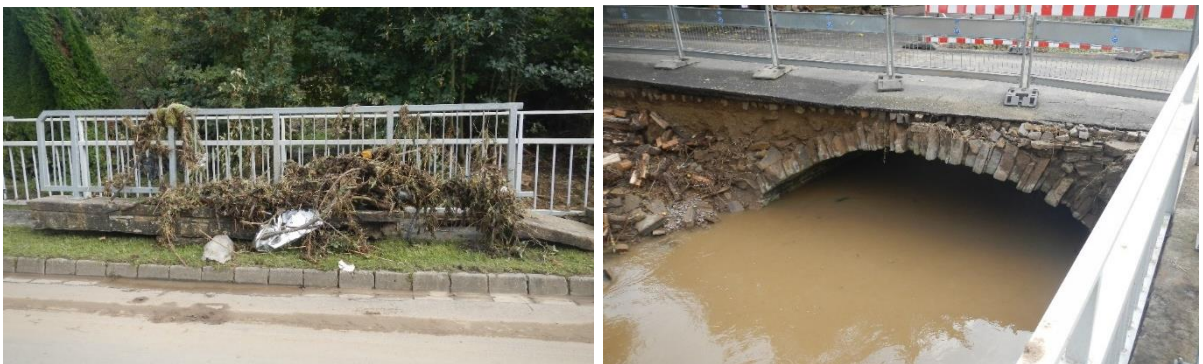
Abbildung 11 Treibgut und zerstörtes Brückengeländer infolge Wasserdrucks (Beispielbilder)
