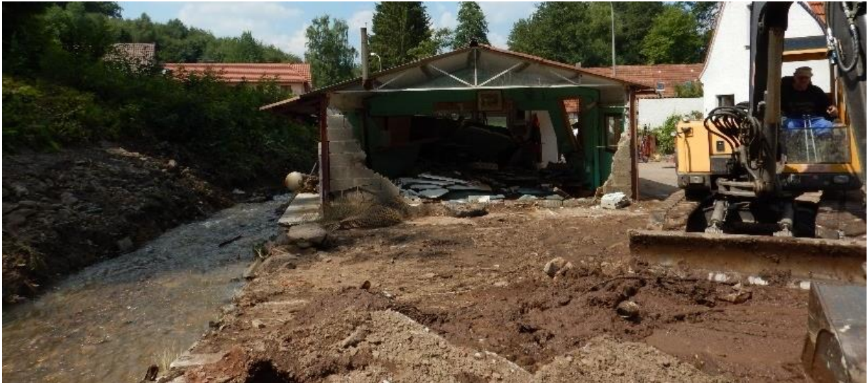
Abbildung 12 Eingestürzte Wand infolge Wasserdrucks (Beispielbild)
