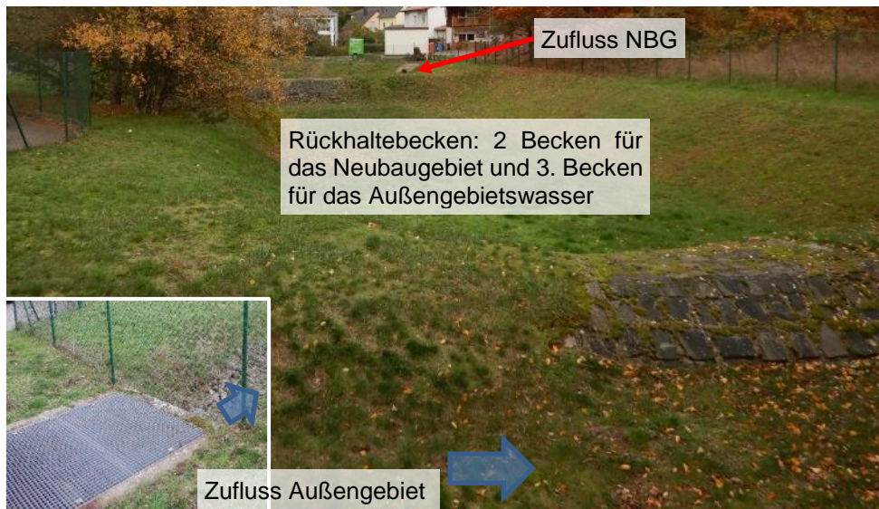
Abbildung 12 Rückhaltebecken NBG und Außengebietszufluss im Frontal
